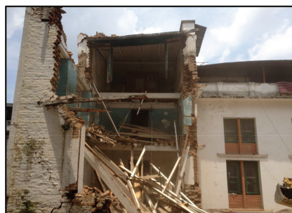
Foto sopra: l'ostello dopo la seconda scossa
